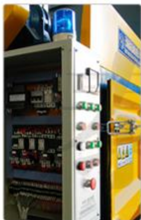
电气控制系统
